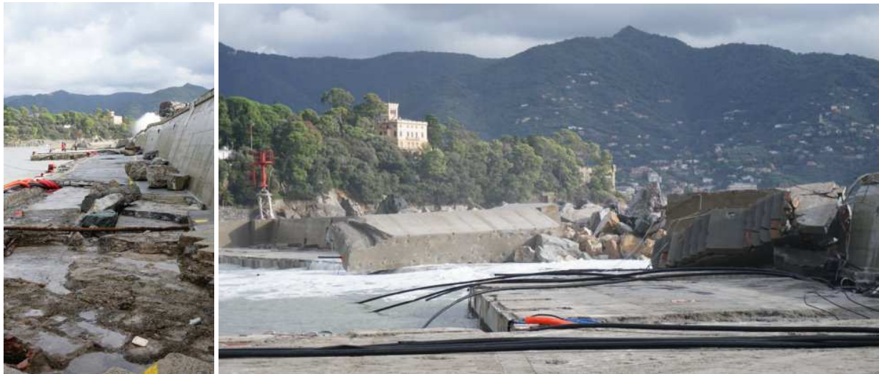
Figura 8 e 9: porto Santa Margherita Ligure post Mareggiata del 29 ottobre 2018
