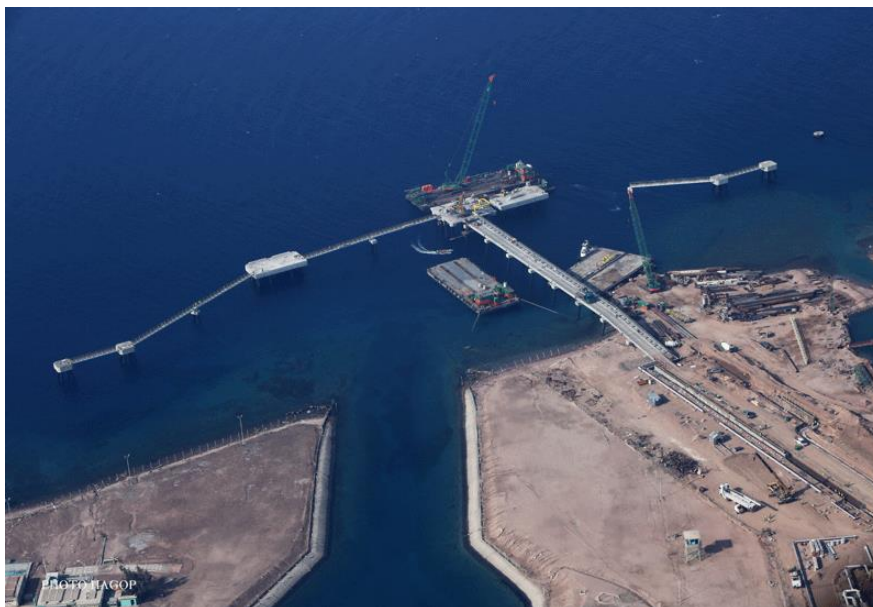
Figura 54. Bahrein LNG Terminal
