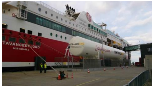
Figure 5-16 : Installation de soutage avec stockage fixe (port de Hirtshals, DK, pour Fjordline)
