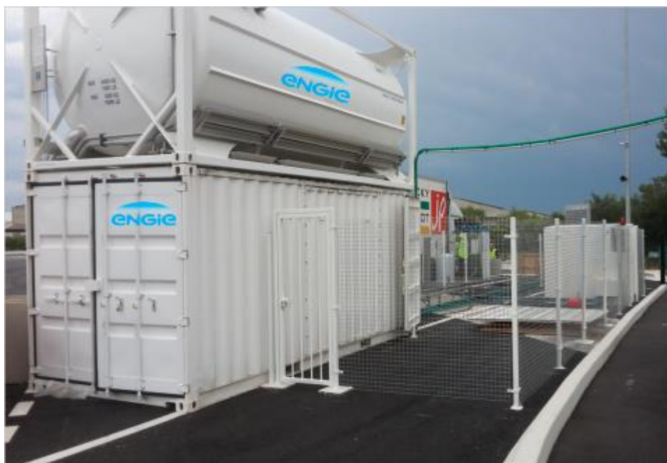
Isocontainer di 20 piedi alla stazione di GNL di Nîmes (fonte: ENGIE)
