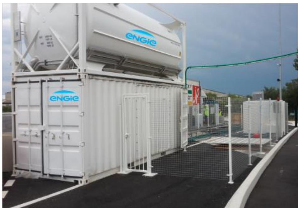
Isoconteneur 20 pieds à la station GNL de Nîmes (source : ENGIE)
