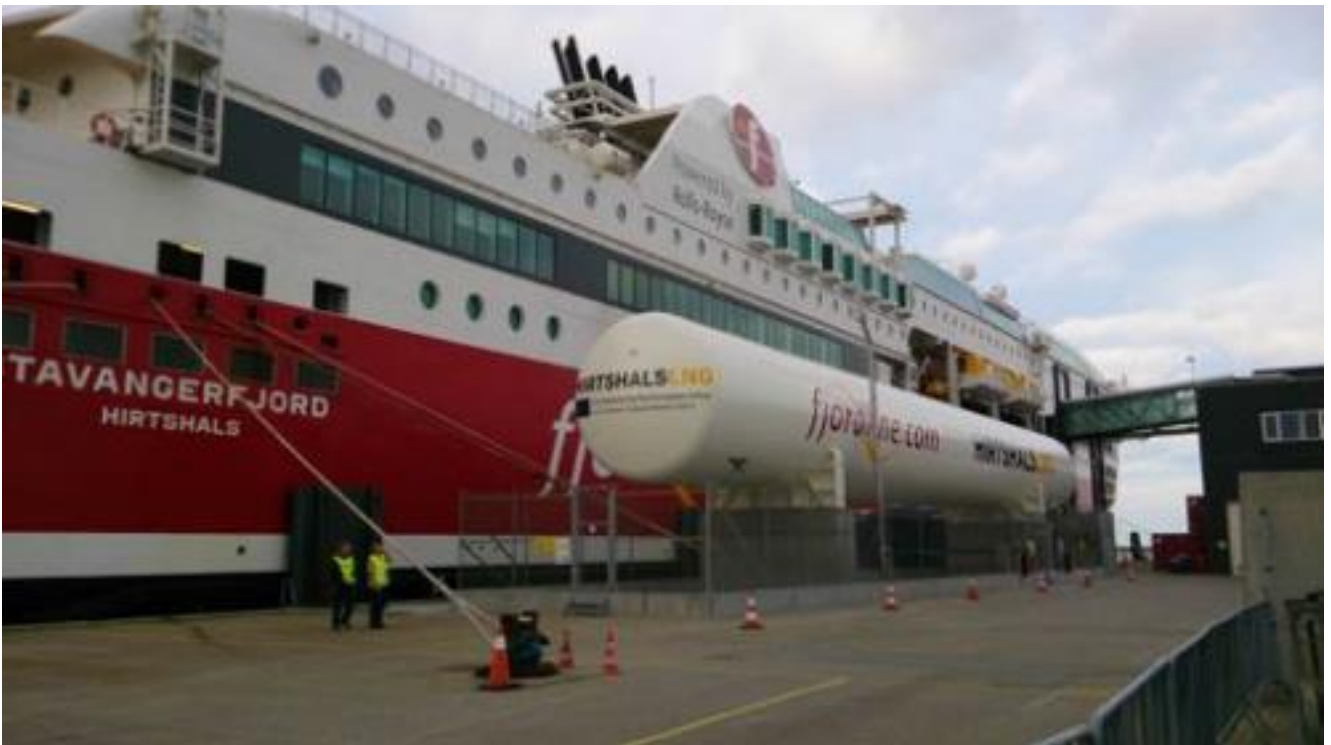
Figure 48 - Installation de soutage avec réservoir de stockage fixe (Port de Hirtshals, Danemark, pour Fjord Line)
