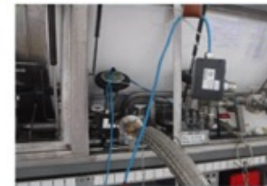
Commande « push button » de déclenchement ESD et détecteur de présence de gaz
