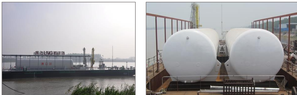
Figura 32: Due serbatoi di GNL da 250m installati sul pontone di Baguazhou
