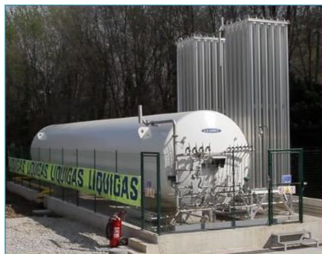
Figura 16. Serbatoio criogenico e vaporizzatore
