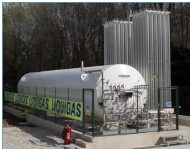
Figura 21 - Serbatoio criogenico e vaporizzatore (Fonte: Luce-Gas.it)
