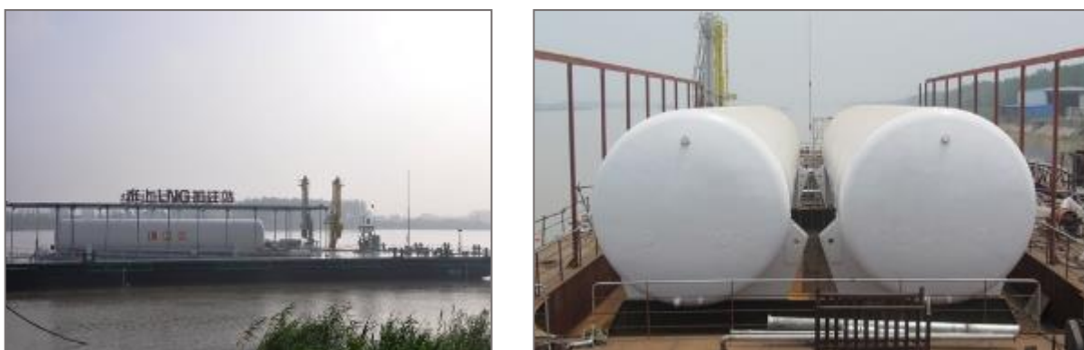
Figure 43 - Deux réservoirs de GNL de 250 m 3 installés sur le ponton de Baguazhou (Source: Jiangsu Haiqiguanghua. CIMC)
