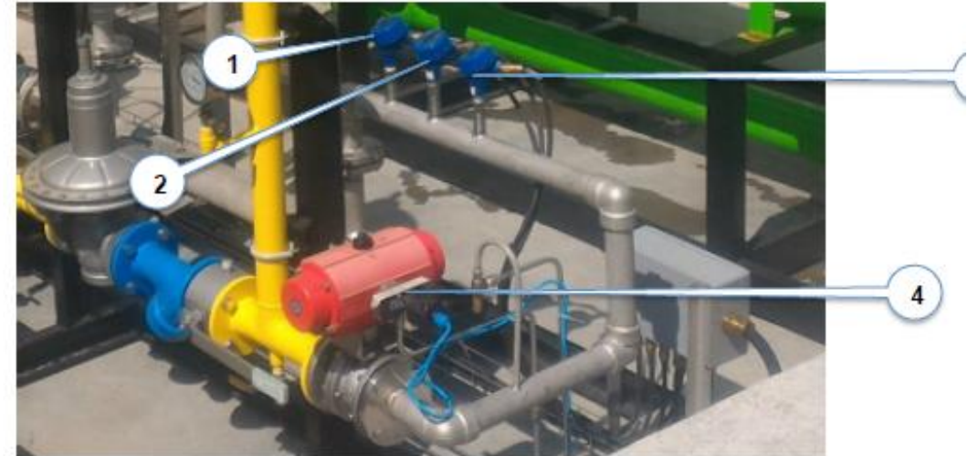
Il sistema ridondante di controllo temperatura (con i tre trasduttori 1, 2, 3) e pressione del metano in uscita dal vaporizzatore, nonché la valvola di blocco (4)
