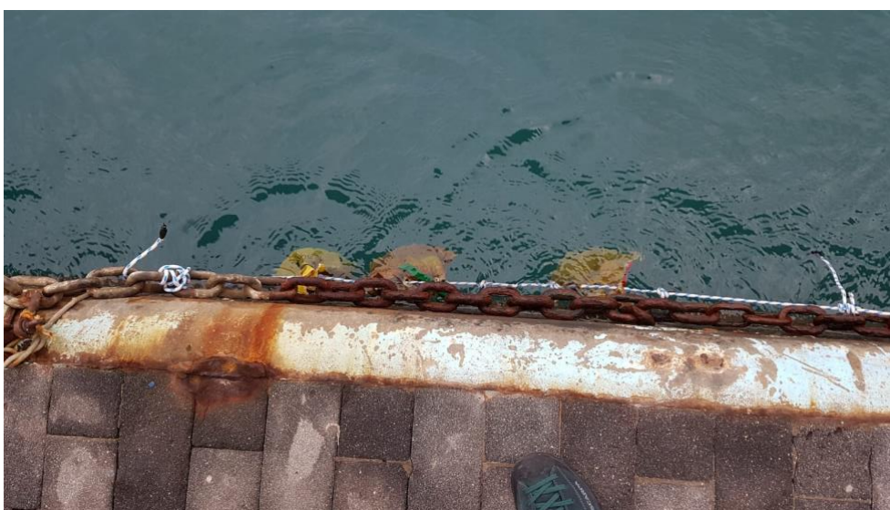
Fig. 2.3.12 – Ispezione alla panne.
