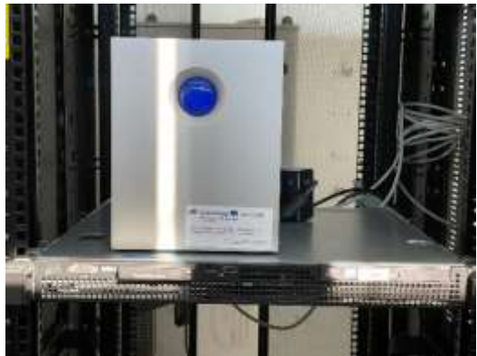
Figura 31: Server di sistema.
