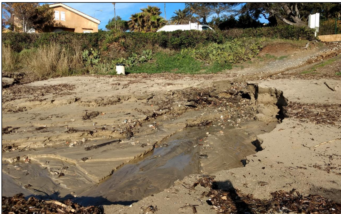
Illustration 4 - Ravinement suite aux écoulements d'eaux pluviales (Source : Commune de Grimaud, 2018/03/16)
