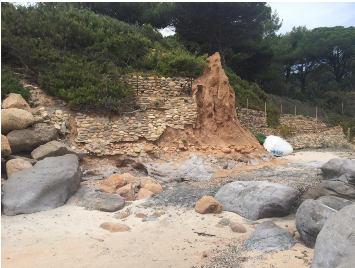
Illustration 14 – Is Morus village résidentiel - Dommages structurels au mur qui délimite la structure.
