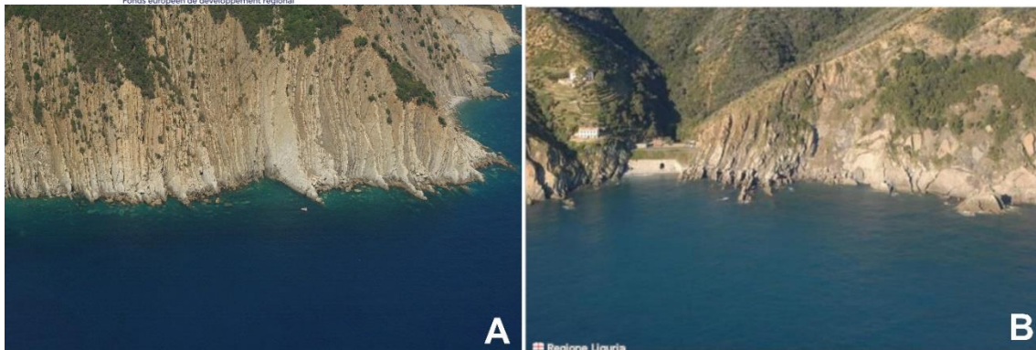
Illustration 2 – Falaise active auprès de Punta Baffe (A) et exemples d'éboulements dus à glissement planaire (B) (de Région Ligurie, photos prospectives de la côte 2010)
