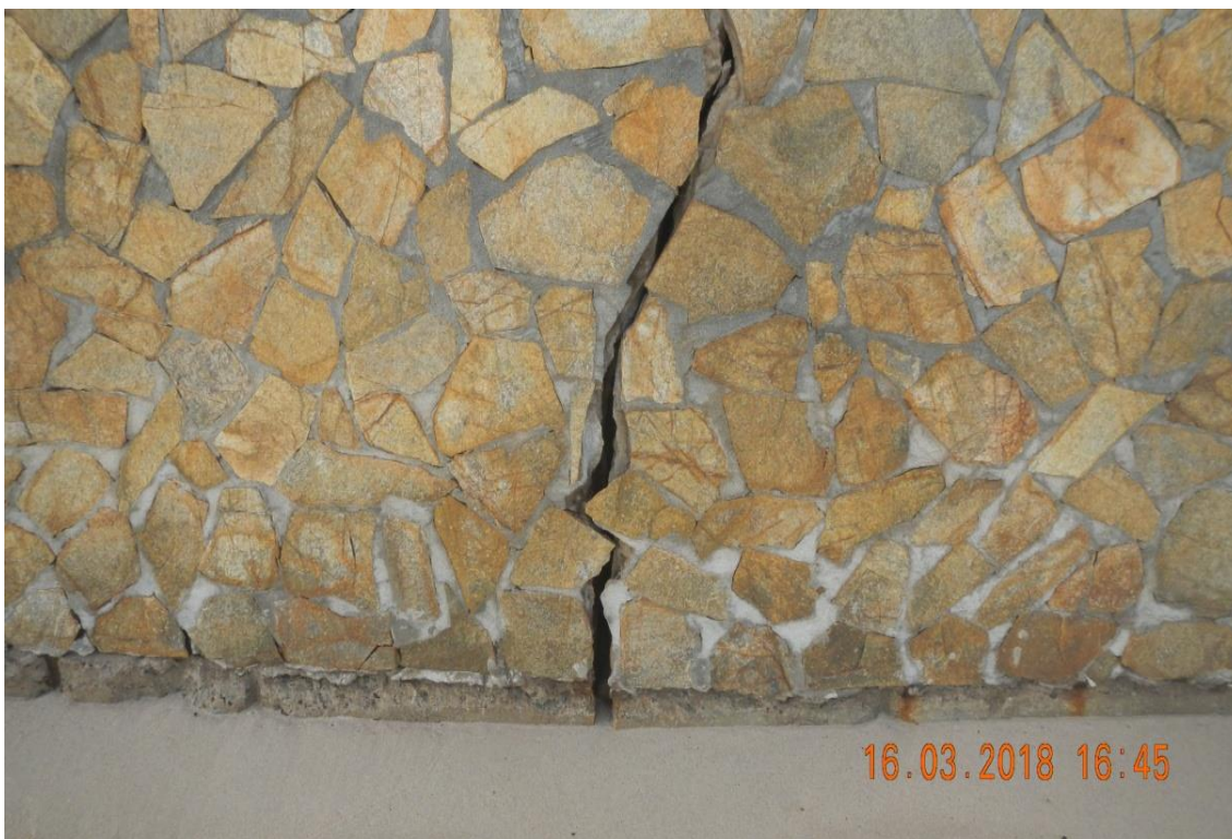
Illustration 12 – Forte Village Resort - La zone de swash affecte la structure du mur car la structure de la plage est dépourvue de berme. La configuration du produit est précaire
