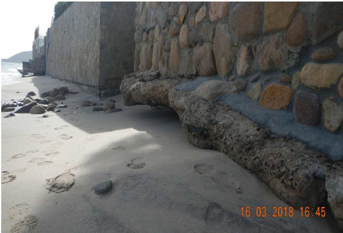
Illustration 13 – Forte Village Resort - Souillement actuel de la fondation du mur.
