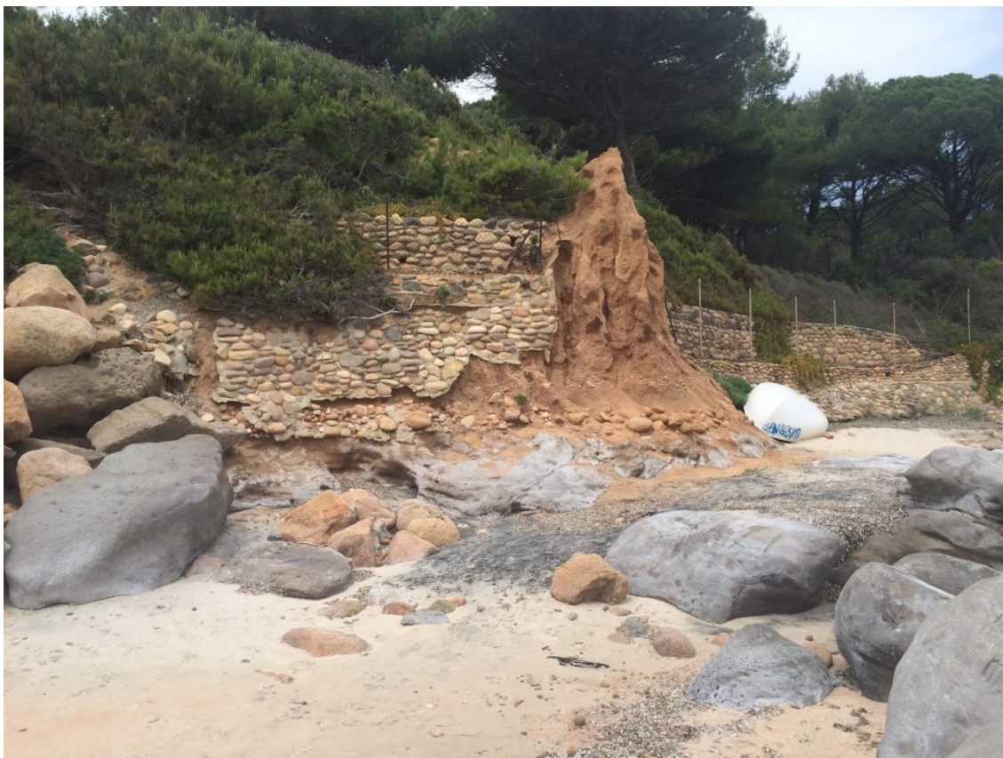
Figura 14 – Villaggio residenziale di Is Morus - Danni strutturali al muro che delimita la struttura.
