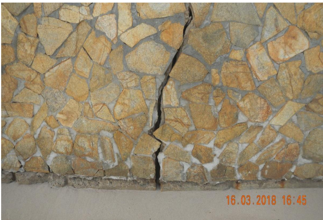
Figura 12 – Resort di Forte Village - Ulteriori danni strutturali al muro che delimita la struttura turistica.
