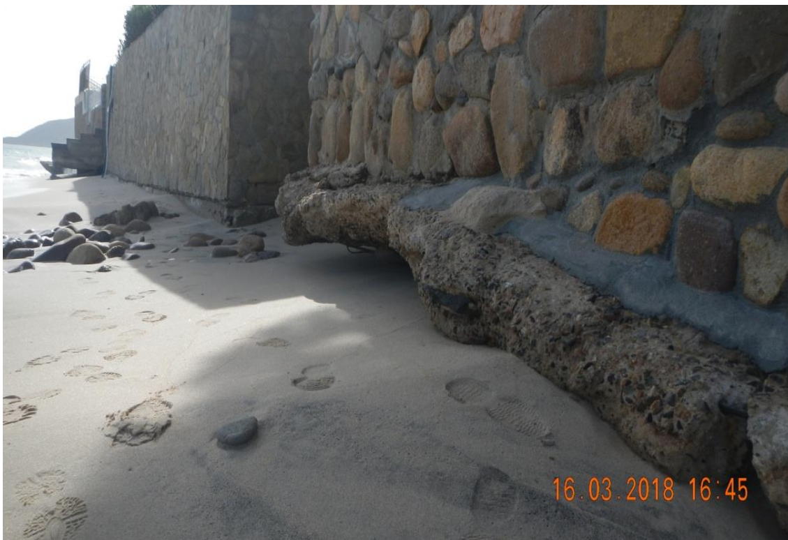
Figura 13 – Resort di Forte Village - Attuale scalzamento della fondazione del muro.
