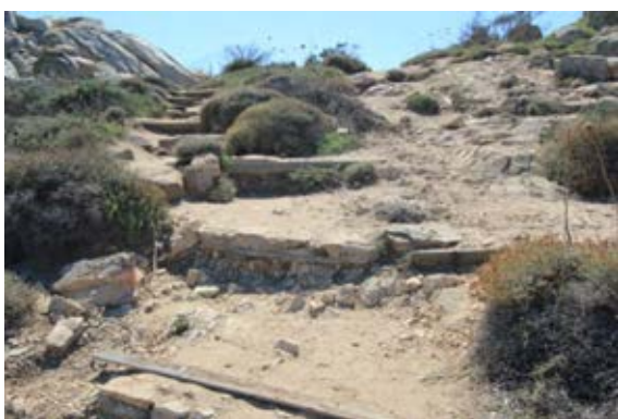
ETAT ACTUEL : Emmarchements irréguliers, endommagés et très hauts.
