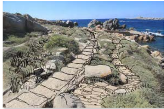
Restauration du mur de soutènement à l'amont du sentier et amélioration du tracé.
