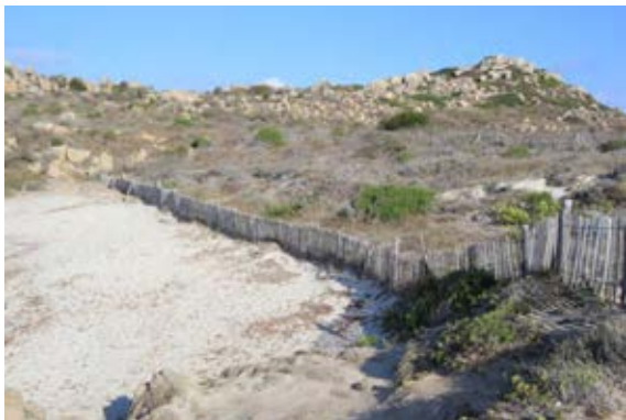
ETAT ACTUEL: ganivelles déjà installées, certaines sont à remplacer et d'autres à déposer (perpendiculaire à la ligne de rivage).
