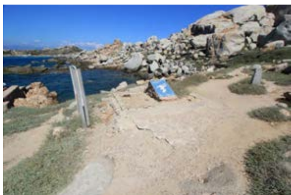
STATO ATTUALE: presenza di pannelli e tracce di cemento.
