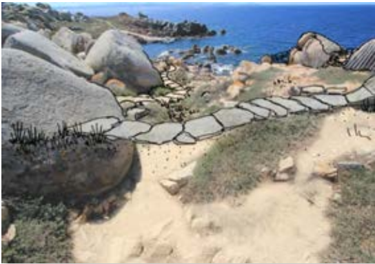
Da monte: muro di sostegno della piattaforma belvedere e chiusura del sentiero esistente.
