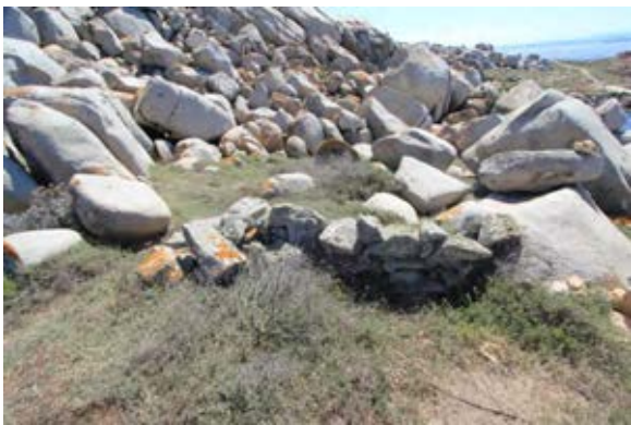
STATO ATTUALE: vecchio muretto basso parzialmente crollata.
