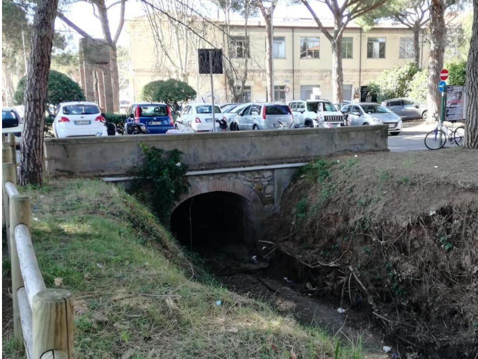
Figura – Sezione del sottopassaggio in cui il Botro Secco inizia il suo tratto tombato prima della foce.
