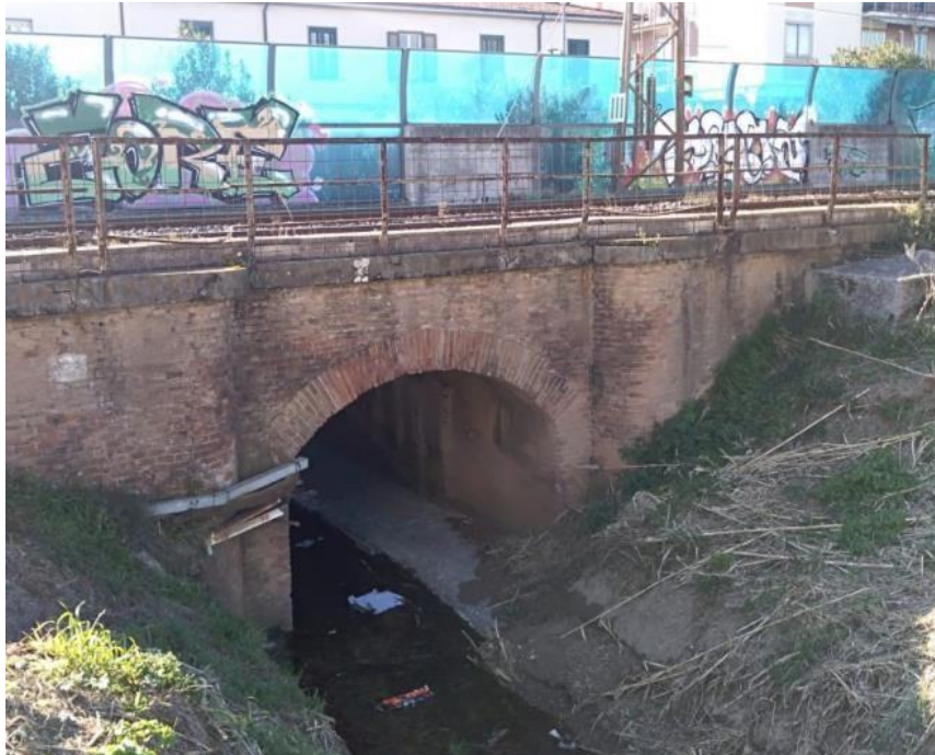
Figura – Sezione del sottopassaggio in cui il Botro Cotone attraversa la linea ferroviaria
